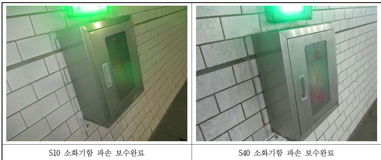
【사진 3.16】 터널 부속시설 손상현황
